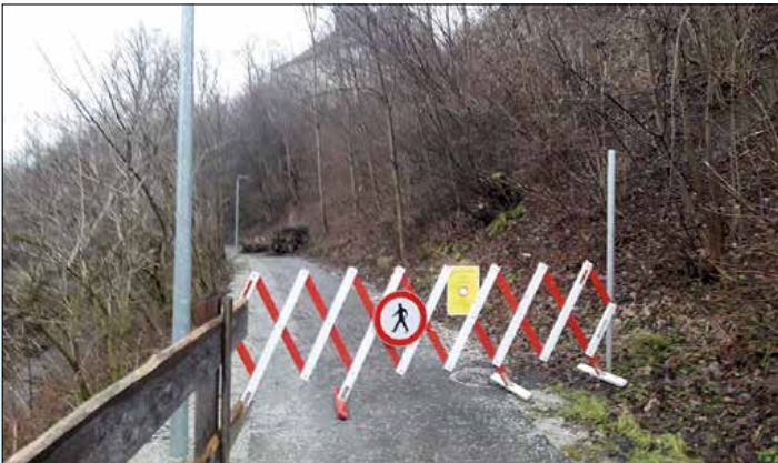
Sperre des Wallerbachweges aufgrund von Hangrutschungen
