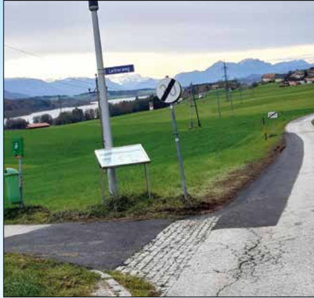
Asphaltmulde Maierhofstraße (GWEV)
